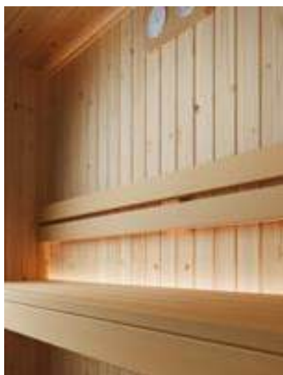
iluminare LED în spatele băncii
